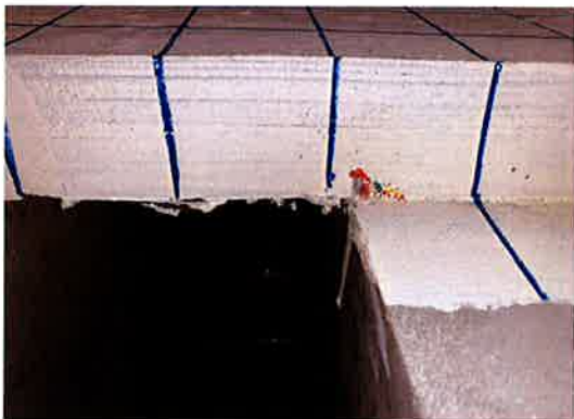
側面 ひび割れと付着切れの様子 2
